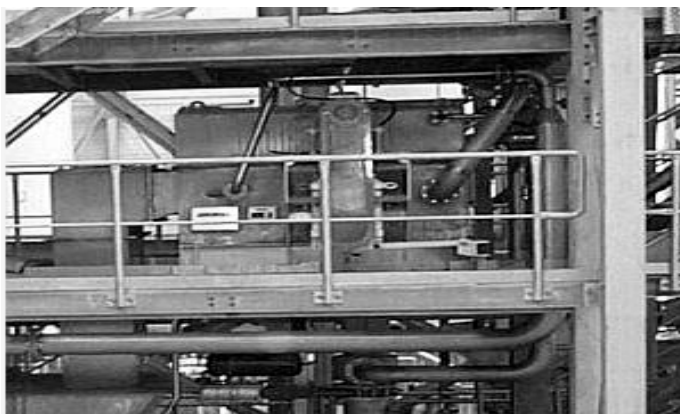
Fig. 1 Instalație de spălare a tocăturii
