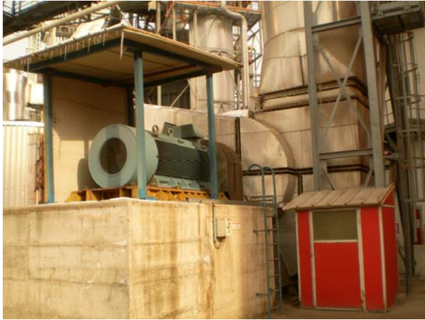
Fig. 9 Motorul ABB de 1800kW de antrenare a ventilatorului cu J = 120000 \text{ kgm}^2
