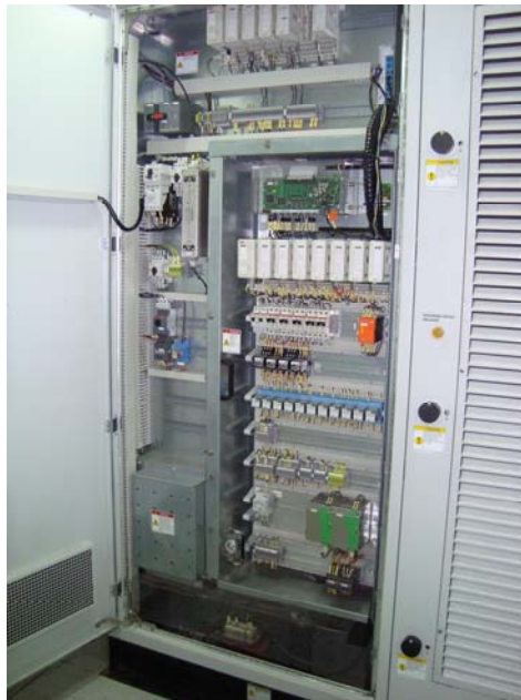
Fig.10 Vedere asupra părții de comandă și automatizare la ACS 5000
