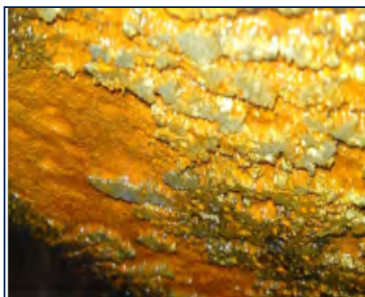
Fig. 2 Eroziune cavitațională la conul aspirator al turbinei Francis, [5]
