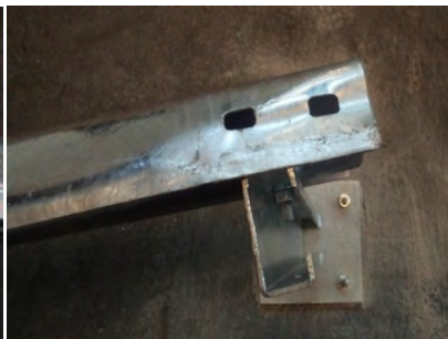
Fig. 9 Stâlp capăt dreapta deformat
