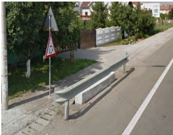
Fig. 1 Parapet alcătuit din lisă și stâlp pe drumurile naționale (DN17)
