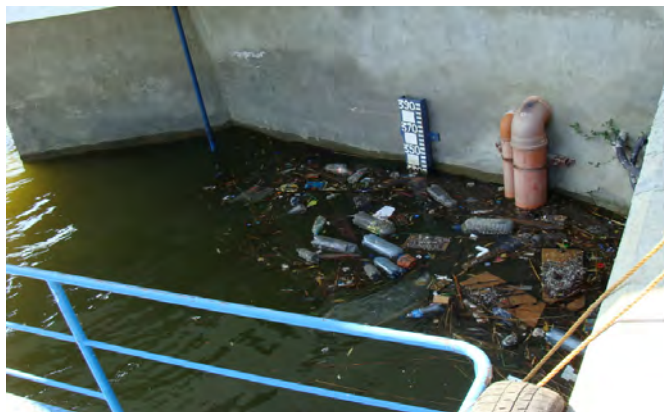
Fig. 1 Bazinul de aspirație al unei stații de pompare, poluat
