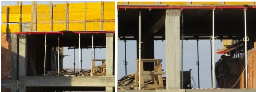
Fig.3 Spații amenajate necorespunzător pentru începerea lucrărilor
