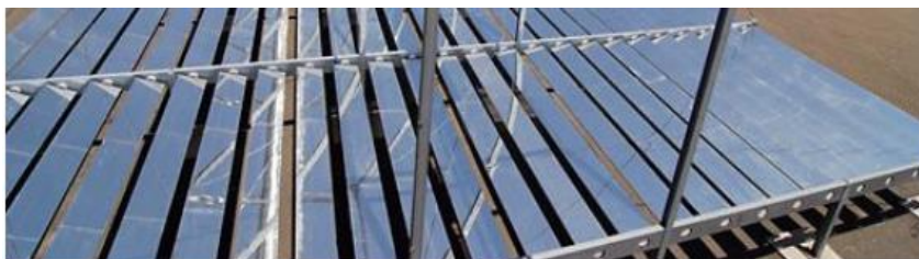
Fig. 2 Panouri fotovoltaice cu concentratoare liniare Fresnel
