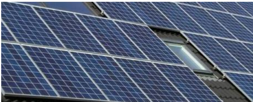
Fig. 1 Panouri fotovoltaice montate pe acoperiș
