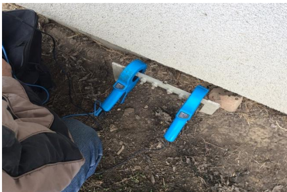
Fig. 3 Cleștii aparatului de măsură la piesa de separație a prizei de pământ
