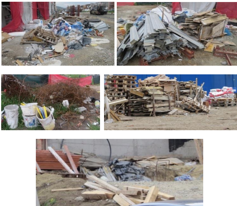
Fig. 3 Depozitare necorespunzătoare a materialelor și deșeurilor
