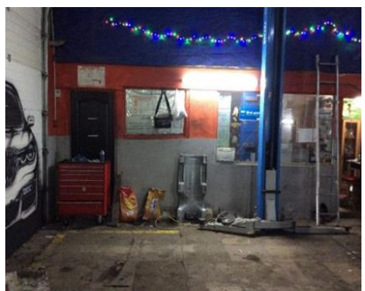
Foto 6: Corp de iluminat general poziționat orizontal pe perete, cu acționare locală
