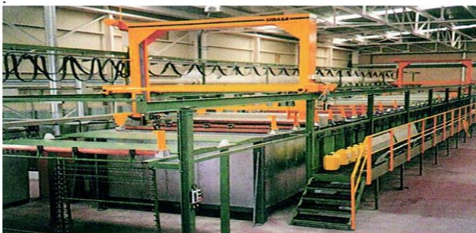
Fig.4 Instalație de zincare termică
