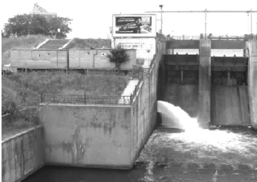
Fig. 1 Vedere generală recentă a Barajului Ciurel, proprietatea A.N Apele Române S.A.: frontal – sunt vizibile câmpurile deversoare cu stăvile de tip clapetă și jeturi de apă (simetric) emergente, lateral stânga - dreapta; la bază, în transparență se observă zona câmpurilor disipatoare a energiei hidraulice; Notabil: Amplasarea MHC Ciurel se realizează în continuarea pragului de beton, din partea stângă a fotografiei; conducta de aducțiune existentă și deja încastrată în corpul Barajului Ciurel, este blindată la adâncime, chiar în zona din spatele panoului publicitar
