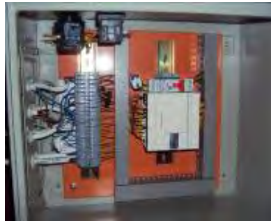
Fig. 11 Interiorul cofretului cu AP
