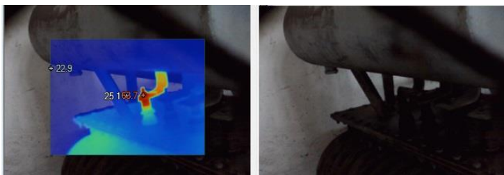
Fig. 13 Transformator de putere dintr-un post de transformare, cu contact imperfect la una dintre bornele de joasă tensiune
