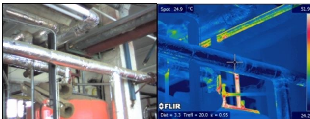
Fig.6 Aplicații în termoenergetică ale termoviziunii
