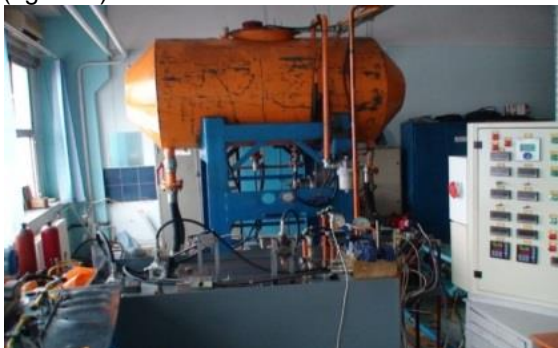
Fig. 4 Stație de pompare pentru stand de testare aparatură hidraulică (Laborator hidraulică INOE 2000-IHP, 2018)
